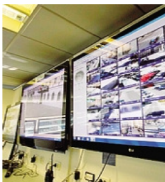
I monitor delle telecamere
