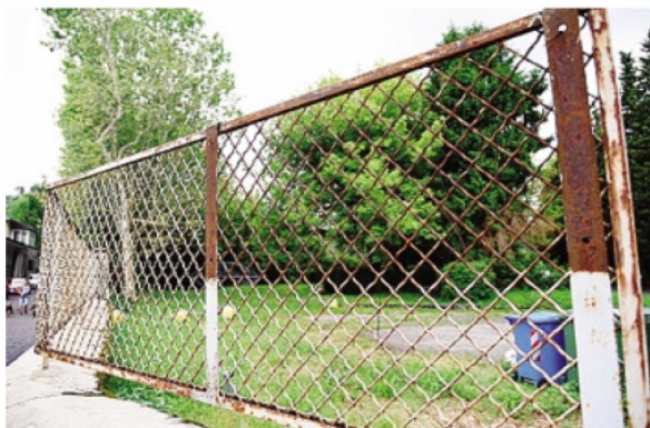
La recinzione arrugginita del campo Utili FOTO BEDOLIS
