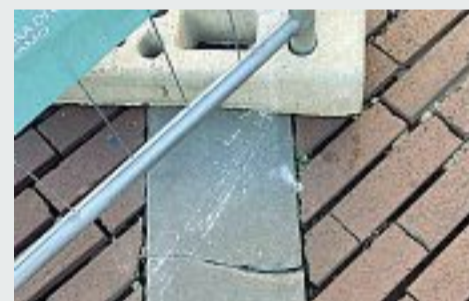
La pavimentazione ammalorata dai ponteggi
