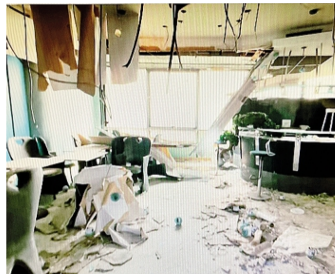
Uno dei negozi del centro commerciale vandalizzato
